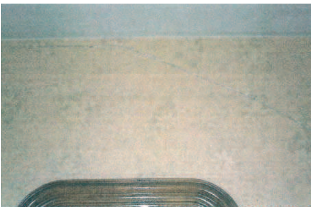
Fissuration intérieure, tapisserie déchirée - Maison André.
