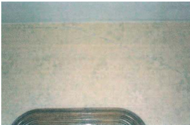
Fissuration intérieure, tapisserie déchirée - Maison André.
